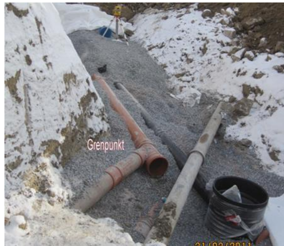
Figur 33 Grenrør (Foto: Terje Rønneberg)
