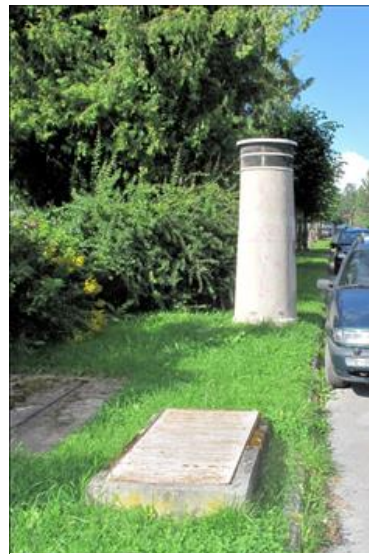
Figur 15 NettverkstasjonAdkomst til underjordisk trafostasjon. Foto: Svein Arne Rakstang, Eidsiva Energi.
