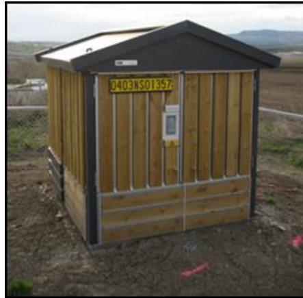
Figur 5 Eksempel på driftsmerking av nettverkstasjon (Kilde: FKB)
